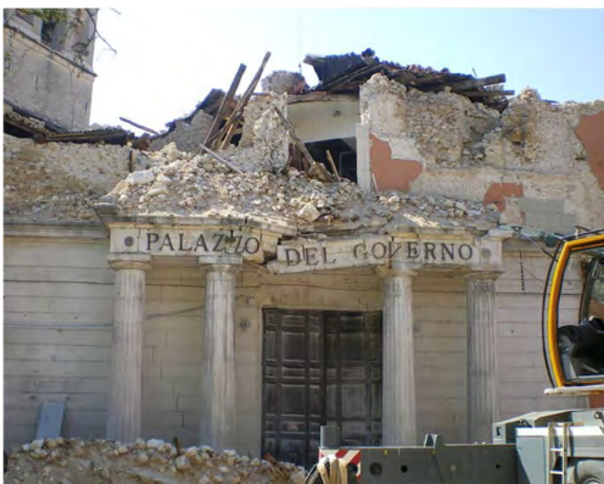
FIGURA 4. Il palazzo del Governo dell'Aquila, fino al 2009 sede di Prefettura e Archivio di Stato, è stato completamente distrutto dal terremoto del 6 aprile, diventando uno dei simboli di quell'evento.
