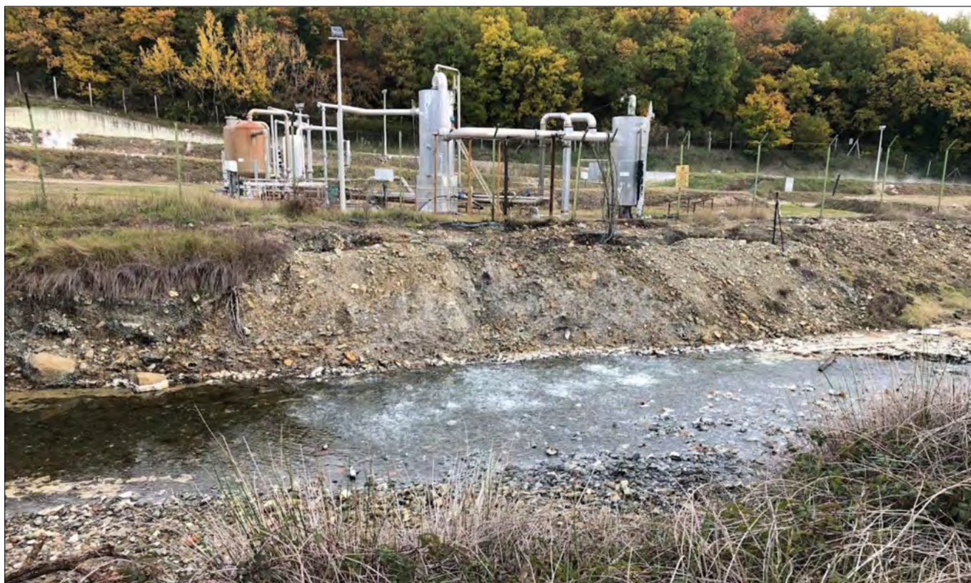
Figura 5. Mofeta del Torrente Ambra (Si): nell'alveo del Torrente si evidenzia la fluenza del gas e sullo sfondo si osserva l'impianto di captazione del gas con i "separatori di strippaggio"
