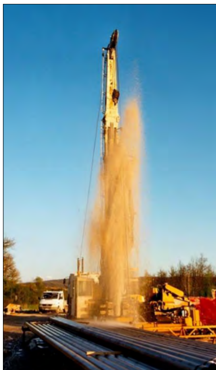
Figura 3. Perforazione di un pozzo minerario per \text{CO}_2 : eruzione incontrollata con l'espulsione e la proiezione del fango
