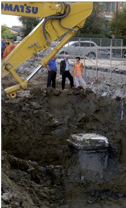
Figura 9 – Modena, via Emilia Est. Monumento funerario di Vetilia (I sec. d.C.) coperto dai depositi alluvionali al momento della scoperta (scavi 2008)
