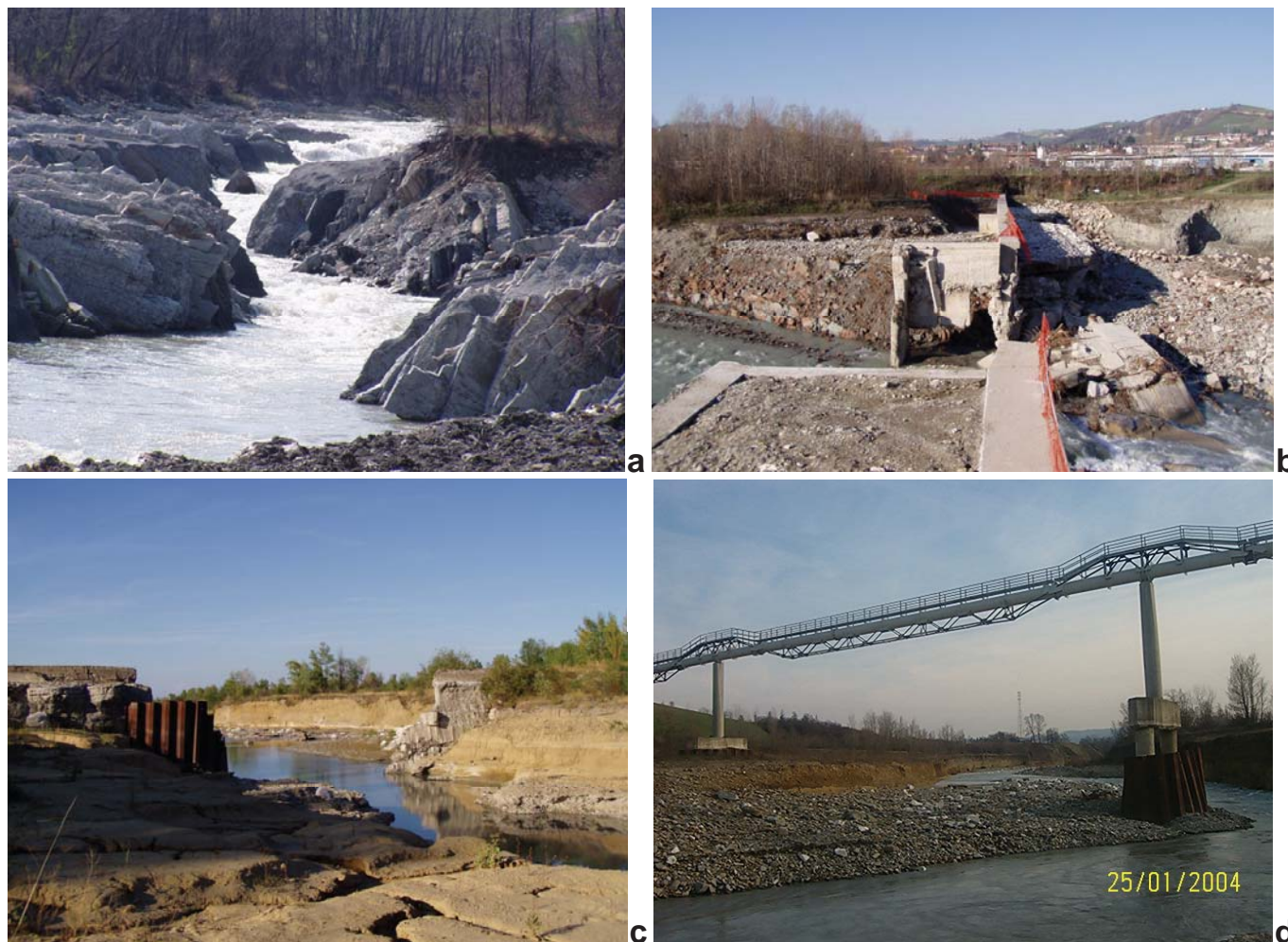
Figura 11 – La forte incisione dell'alveo del fiume Secchia (a) e le opere idrauliche e infrastrutturali danneggiate dal suo abbassamento.
