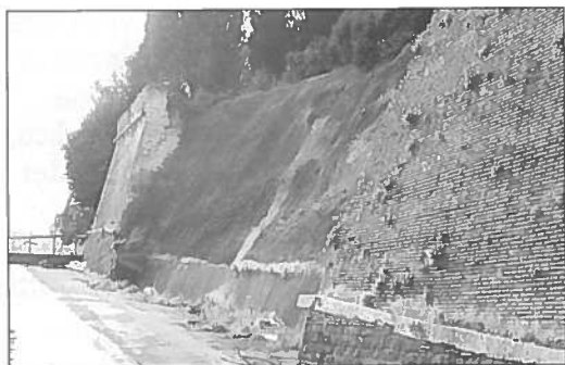
Foto 1 - Frana di Villa Sciarra (Foto F. Leone).
