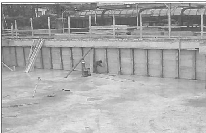
Figura 7 - Esempio di paratie di contenimento tipo berlinese con infissione statica di profilati metallici.
