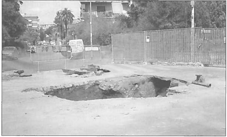
Figura 3 - Esempio di sprofondamento della sede stradale a causa della presenza di cavità sotterranee nei pressi di via Casilina a Roma.
