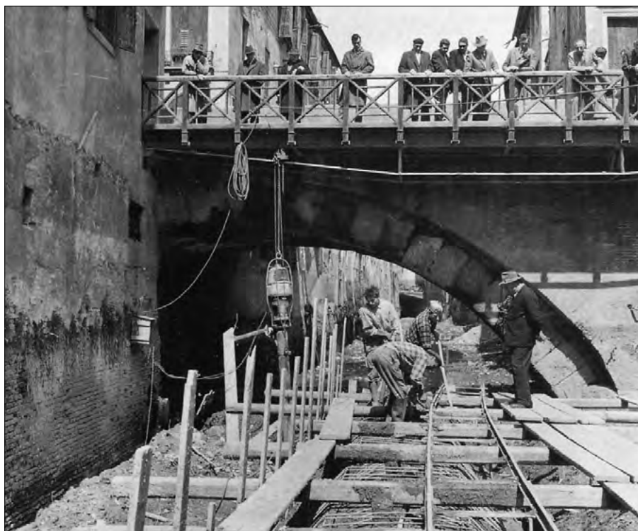
Figura 9. Padova, Riviera dei Ponti Romani. Operazioni di tombinamento del Ponte Altinate nel 1956-1957 (© Gabinetto fotografico, Musei Civici di Padova)
